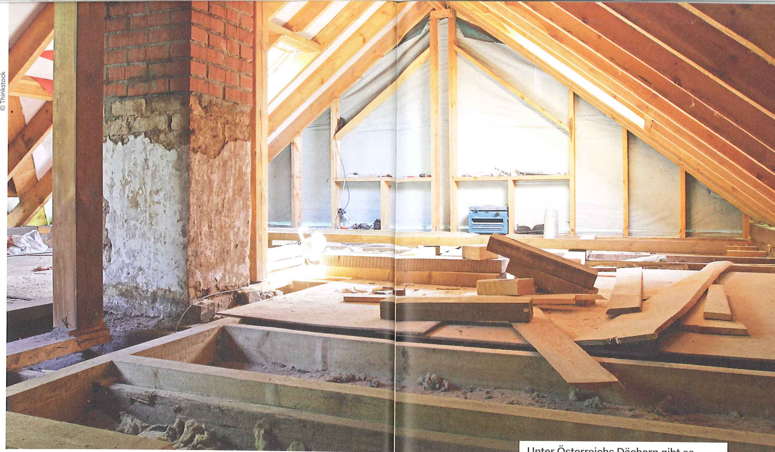
Unter Österreichs Dächern gibt es noch genügend Sanierungspotenzial.
