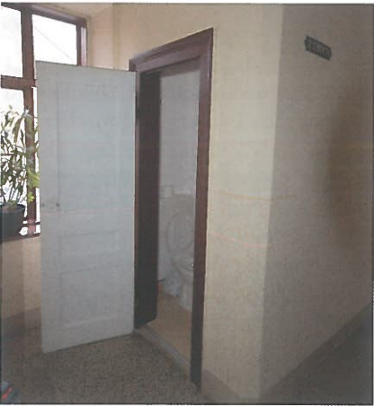
Abb. 6: Veraltete sanitäre Anlagen [© Ulreich Baurträger GmbH]
